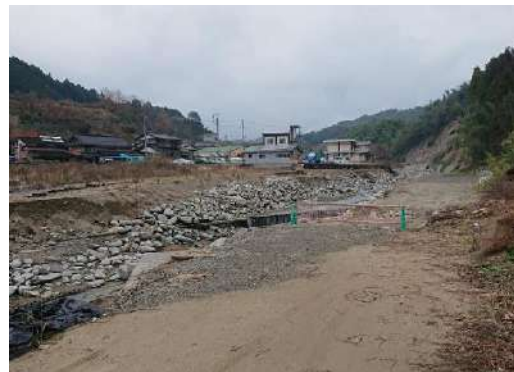
写真2 福岡県朝倉市の豪雨災害の現場
